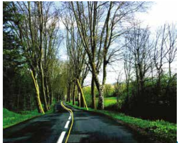
• Les indices de glissement de terrain sont souvent visibles : arbres penchés, routes déformées, etc... ici à Priay sur la RD984
