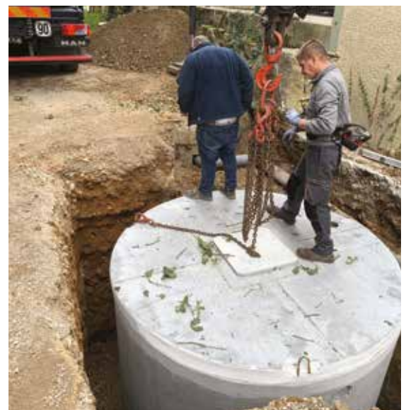
• Cuve de récupération des eaux pluviales
